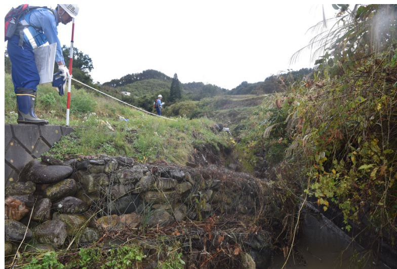
【長野県上田市: 被災状況調査状況】
