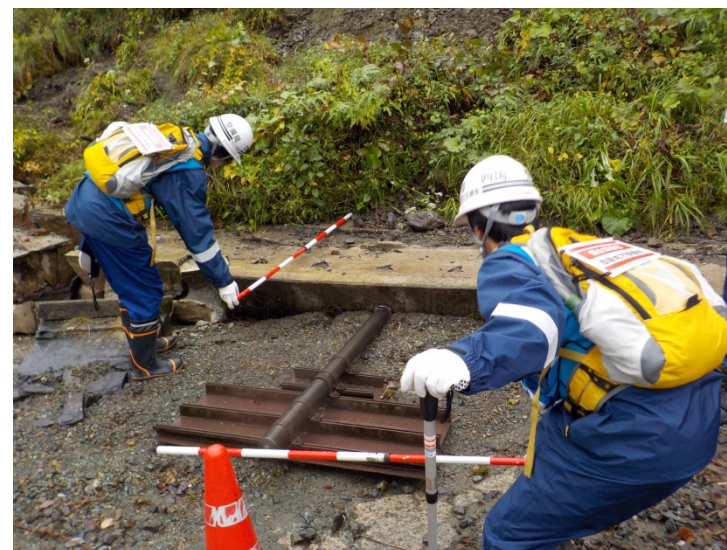
【群馬県甘楽郡下仁田町:被災状況調査状況】
