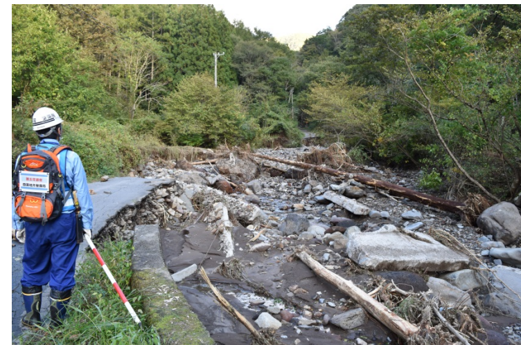
【長野県上田市:被災状況調査状況】
