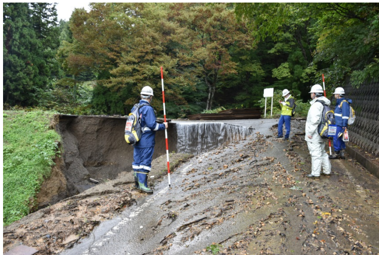
【新潟県妙高市:被災状況調査状況】
