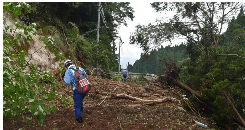
【道路班：道路被災調査(多久市)】
