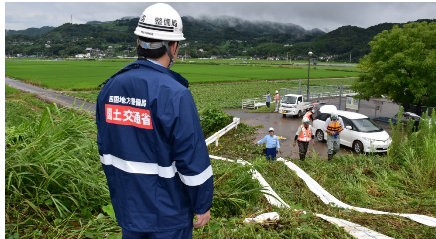
【排水ポンプ配置状況】
