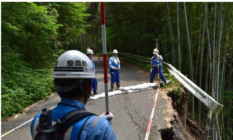
【鹿屋市輝北町諏訪原:被災状況調査状況】
