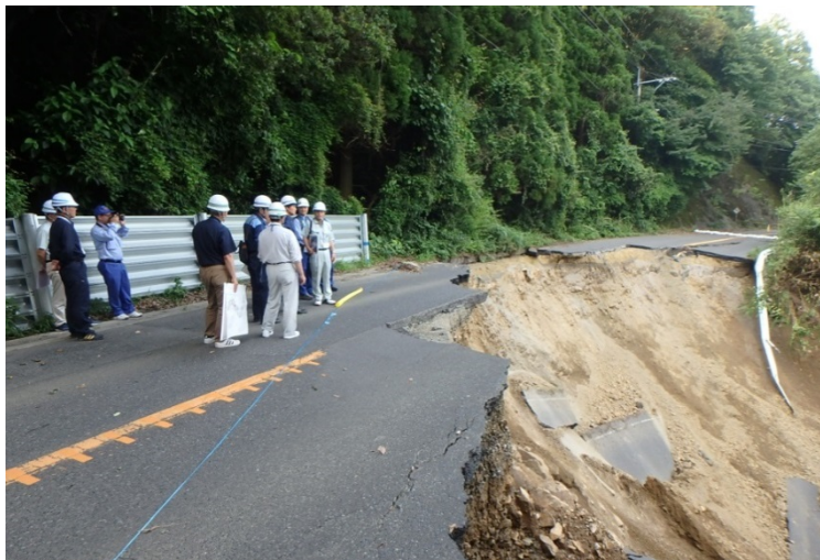
【主要地方道谷山知覧線被災状況確認】
