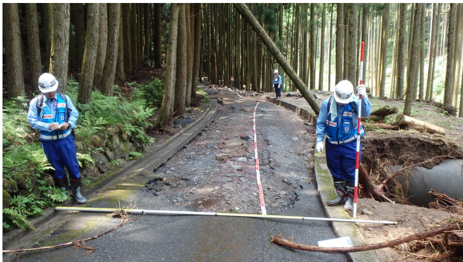
道路(舗装面)流出状況
