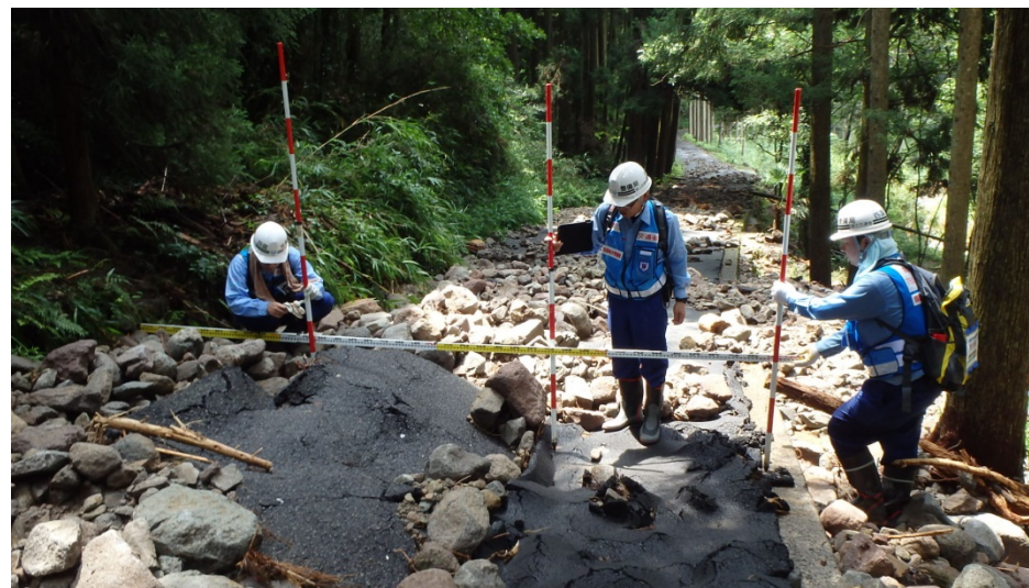
道路崩壊状況
