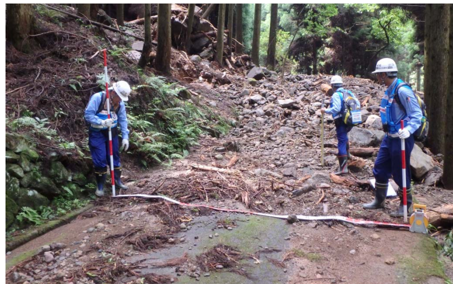
道路閉塞状況①
