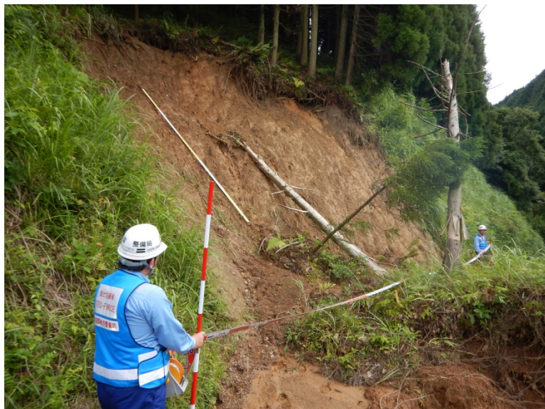
土砂災害による道路閉塞状況
