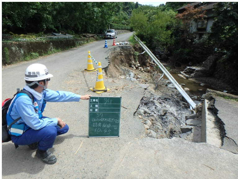
道路(路肩)崩壊状況
