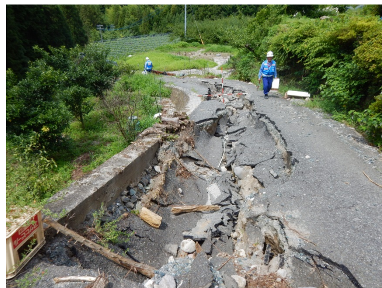
道路陥没状況②
