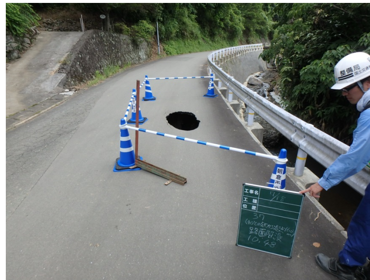
道路陥没状況①
