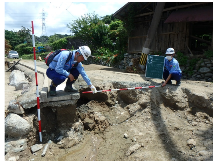
道路の被害状況調査
