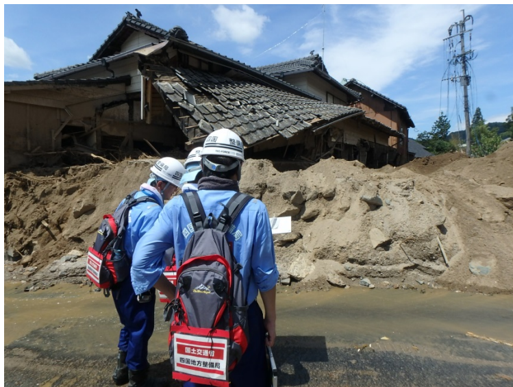
道路・家屋の被害状況調査
