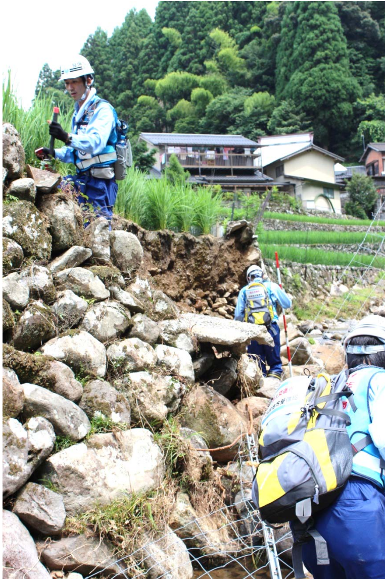
河川班の被害状況調査(大分県日田市)
