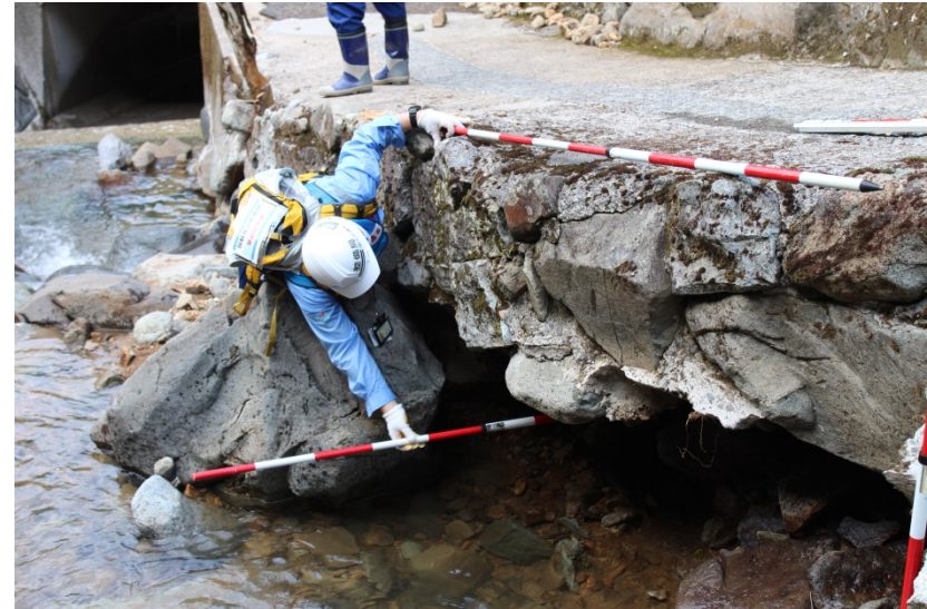
砂防班の被害状況調査(大分県日田市)
