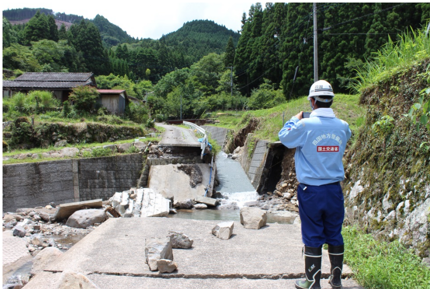
崩落した橋の被災状況調査
