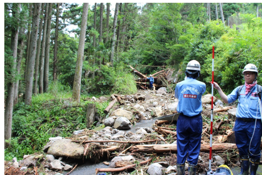
道路の土砂災害状況調査
