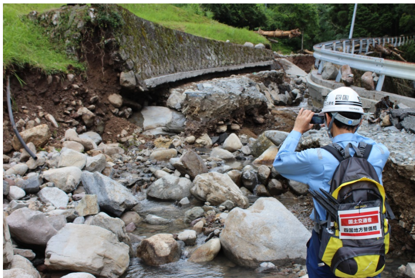
崩落した道路の被災状況調査
