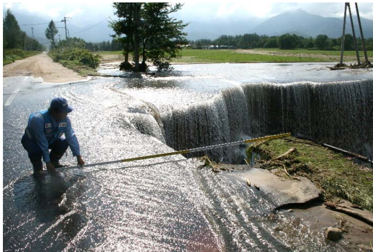
久山川 氾濫状況調査
