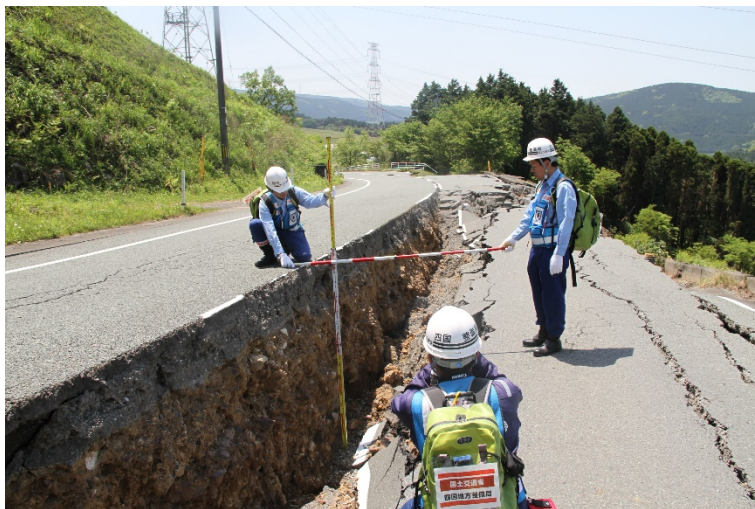
法面崩壊による沈下状況を調査する隊員(県道28号)
