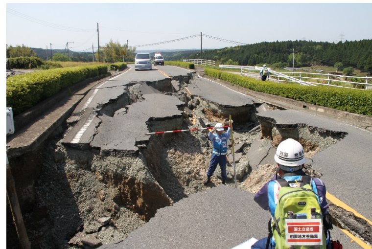
陥没状況を調査する隊員(県道28号)
