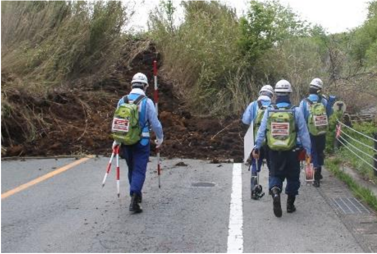
崩落箇所を調査する隊員(県道28号)
