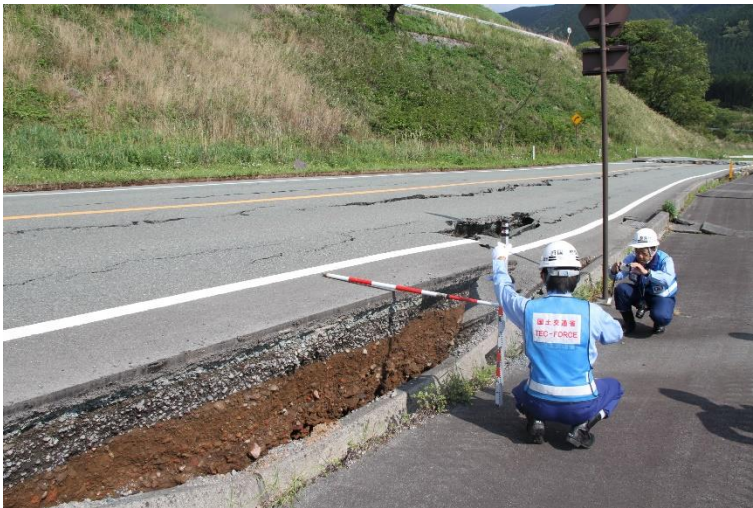
道路の沈下状況を調査する隊員(県道28号)
