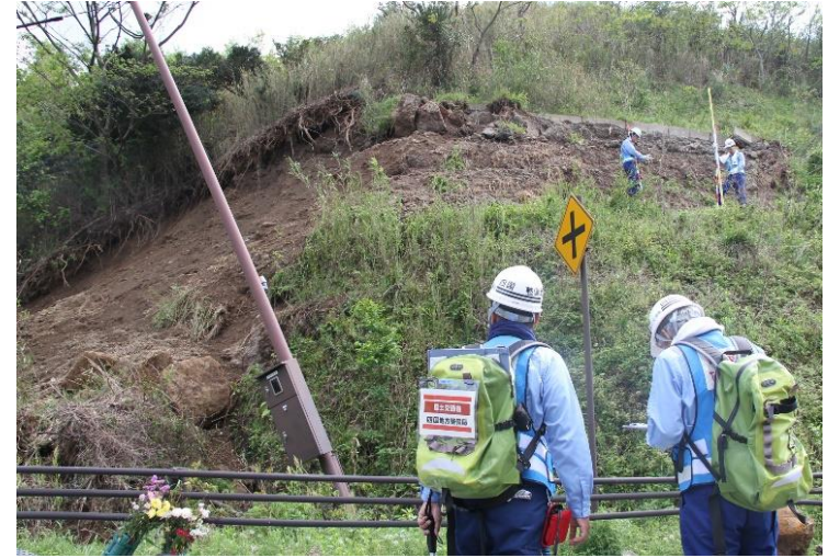
崩落箇所を調査する隊員(県道28号)
