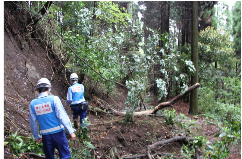
被災した村道を調査しながら進む隊員
