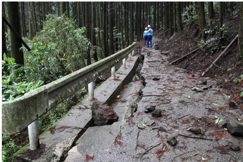
孤立地域へと続く村道のひび割れ、沈下状況
