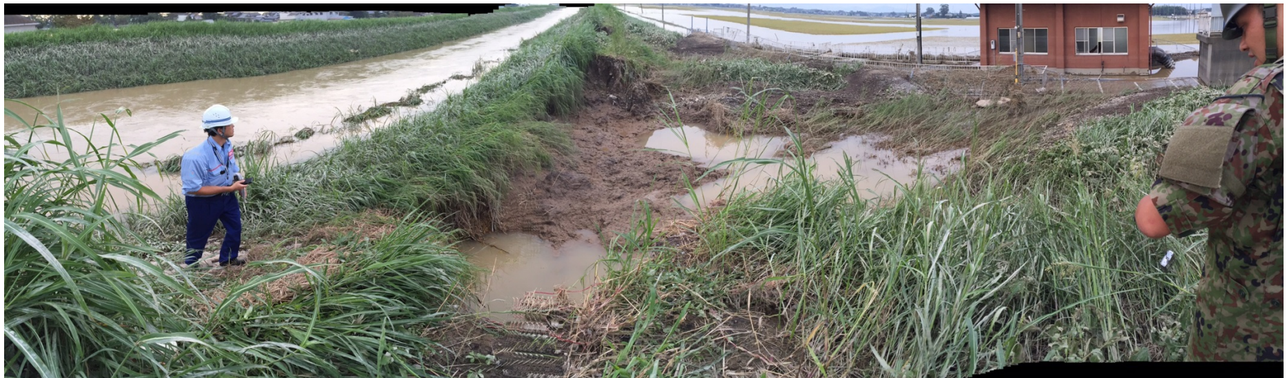
破堤箇所を調査するTEC-FORCE隊員
