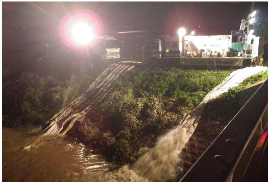
排水ポンプ車稼働状況
