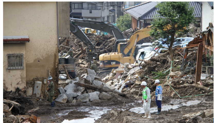
流水箇所の状況確認(八木地区)
