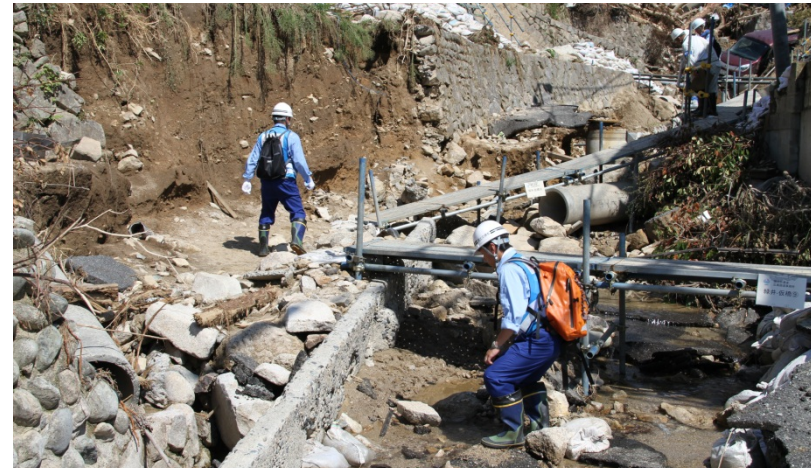
流水箇所の確認(緑井地区)
