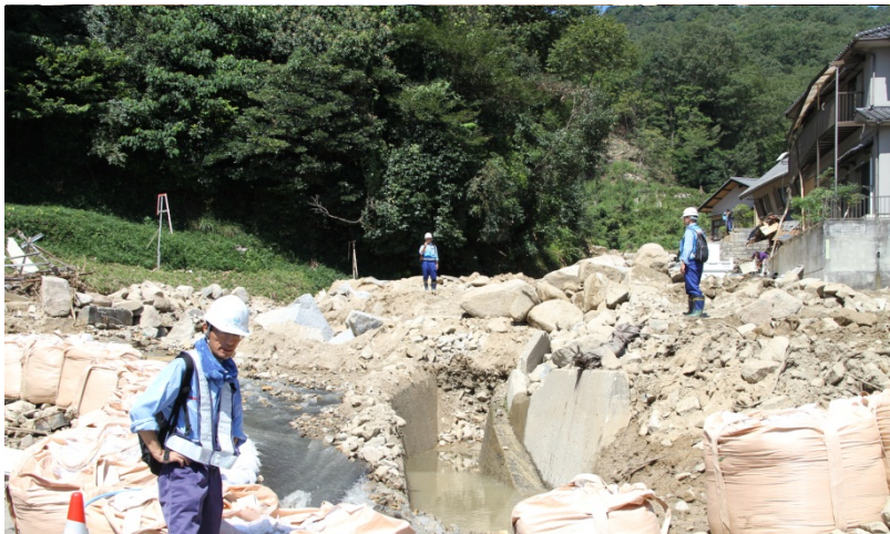
流水箇所の確認(緑井地区)
