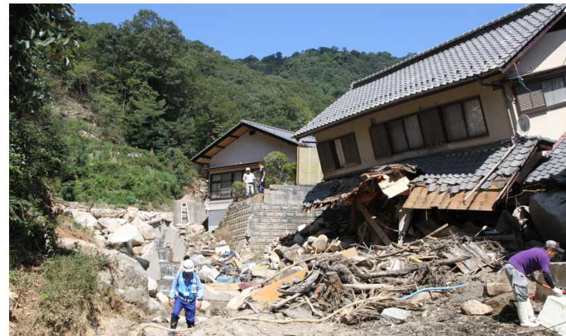
流水箇所の確認(緑井地区)
