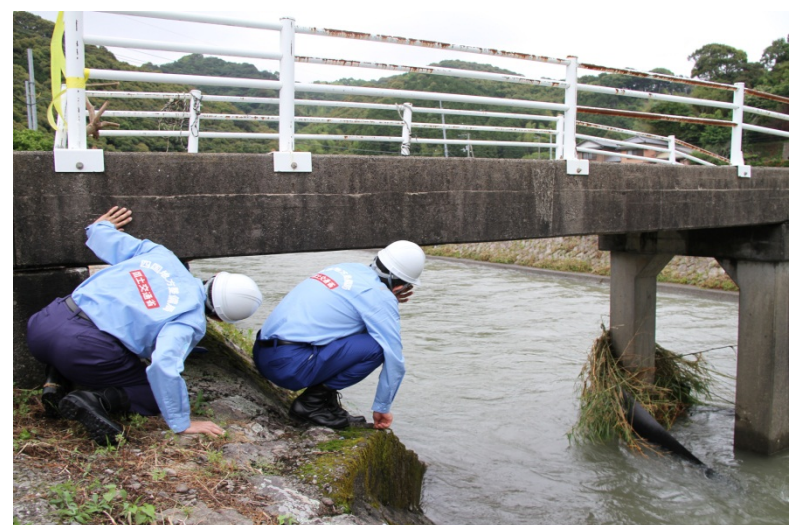
被災した橋梁の被災状況確認
