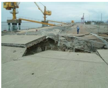
護岸の被害(いわき市)
