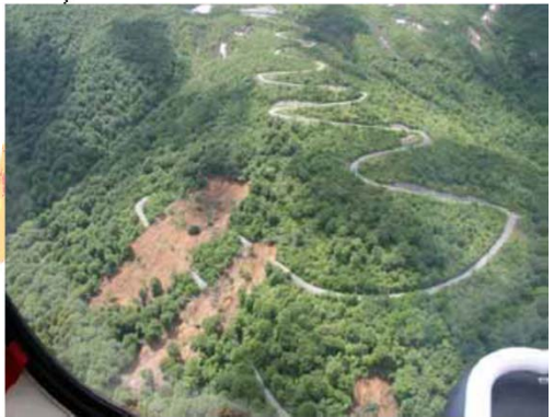
法面崩落(宮城県栗原市) H20岩手・宮城内陸地震
