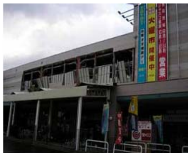
はがれ落ちた外壁 (小千谷市)
