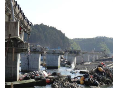
橋梁の被害(南三陸町)
