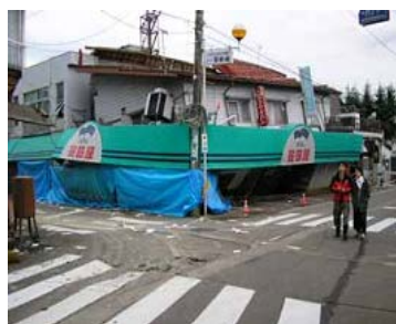
1階部分が潰れた店舗 (長岡市)
