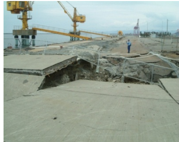
護岸の被害(いわき市)
