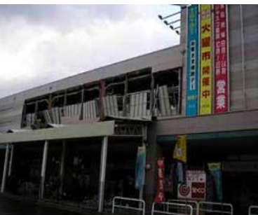
はがれ落ちた外壁 (小千谷市)
