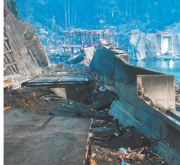
道路の被害(釜石市)
