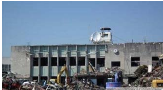
庁舎の被害(大槌町)
