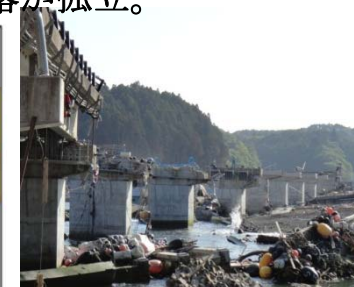
橋梁の被害(南三陸町)
