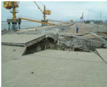
護岸の被害(いわき市)
