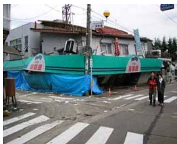
1階部分が潰れた店舗 (長岡市)
