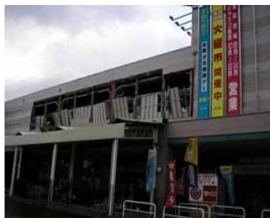
はがれ落ちた外壁 (小千谷市)
