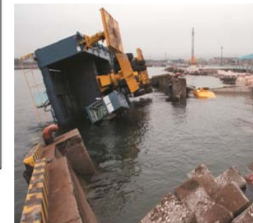
荷役機械の転落(相馬市)
