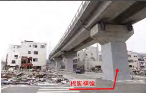
国道45号（観測震度：震度6弱）
