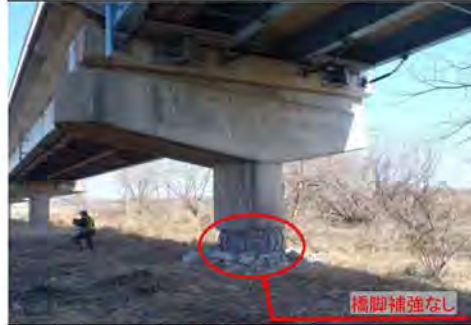
県道（観測震度：震度5弱）
