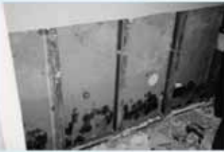
カビ等により取り替えが必要な壁
