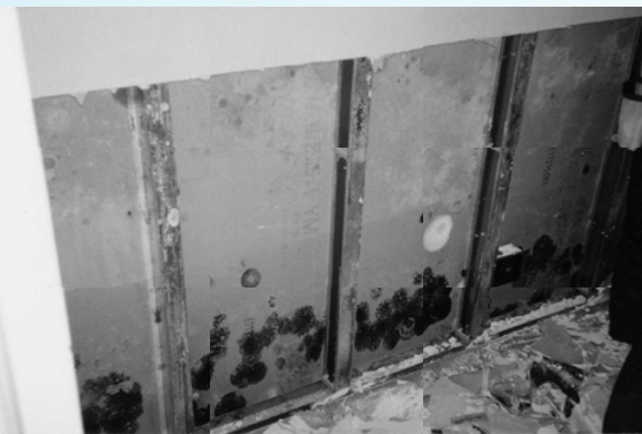
カビ等により取り替えが必要な壁
