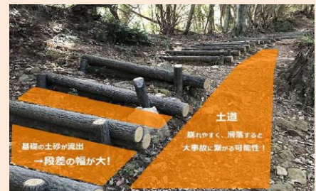
階段状の遍路道は土砂が流出し、段差が広がり危険
