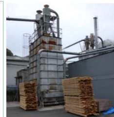
▲木質バイオマスボイラー
