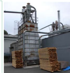
▲木質バイオマスボイラー
