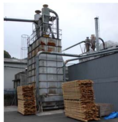
▲木質バイオマスボイラー
