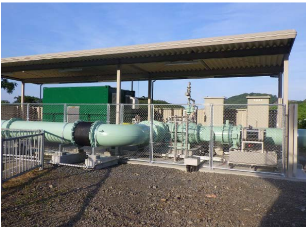
写真-5 主ポンプ、原動機、吐出弁等設置状況
