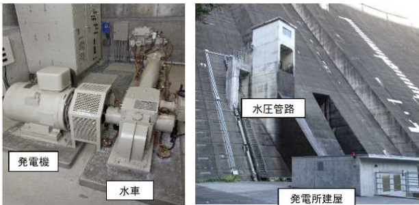
図-6 管理用発電設備
