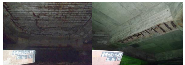
写真-3 上部工(床版下面)の鉄筋露出状況
