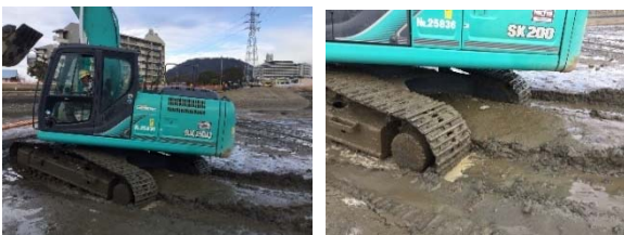
写真-1 底泥土状況
