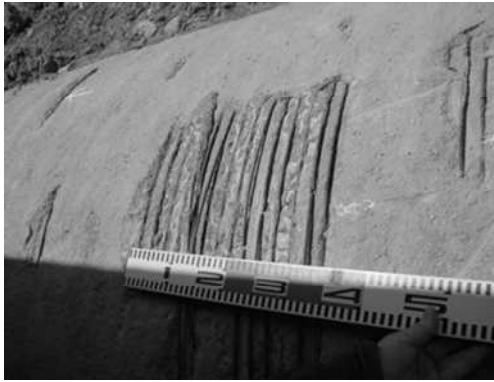
写真-1 高瀬支線水路におけるPC管の劣化状況
