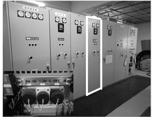
写真-4 増設接続端子(動力分岐盤)
