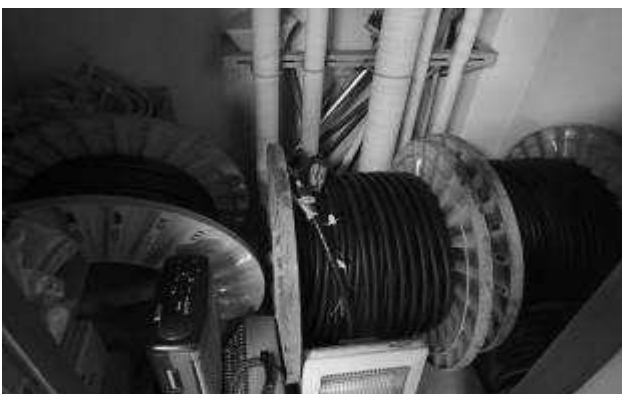
写真-3 可搬電源ケーブル
