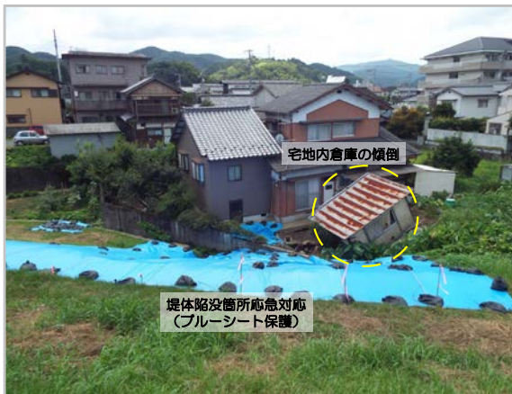
図-2 パイピング被害状況
