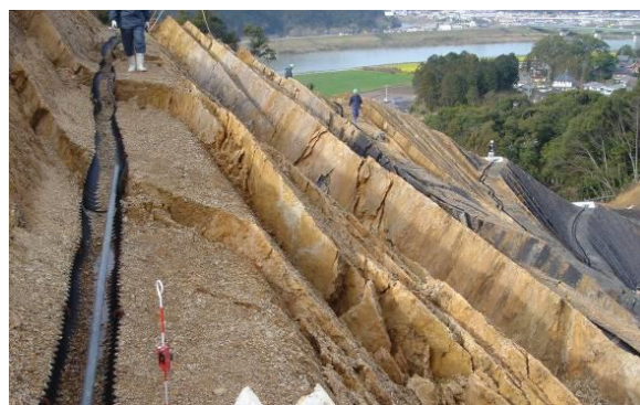
写真-1 切土のり面施工時の変状事例（トップリング）
