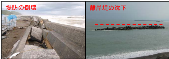
図-3 平成26年台風第11号による被災状況
