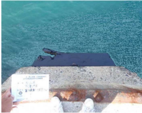
図-7 現況の防舷材（破損）
