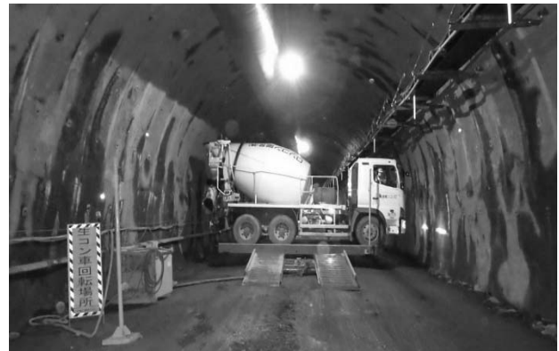
図-7 ターンテーブル使用状況
