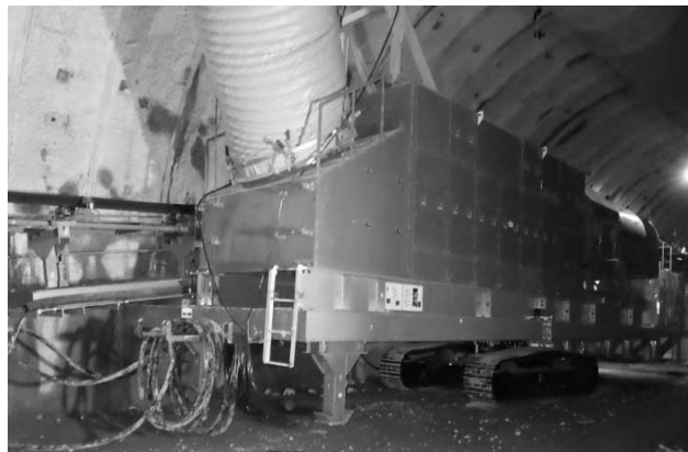
図-8 集塵機搭載型カテナリー台車
