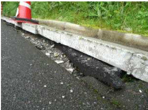
写真-2 側溝の浮き上がり状況
