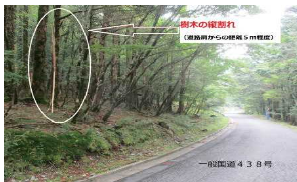
写真-8 沿線樹木の縦割れ
