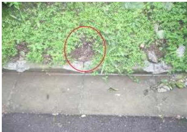
写真-5 V字破損と穴の状況
