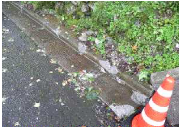
写真-4 継ぎ目部の破損状況
