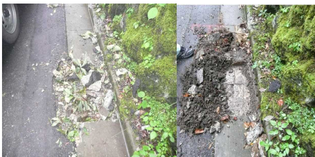
写真-6 完全に破壊されている状況
