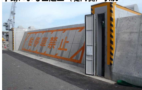
手動による全起立（堤外側）状況
