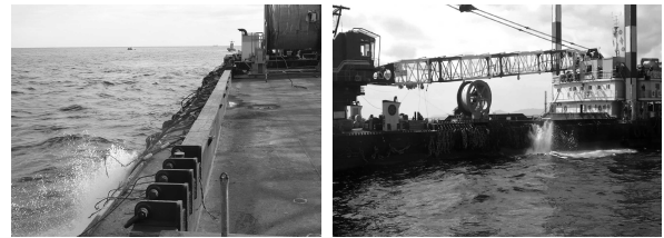
写真-5 固縛ワイヤー切断状況
