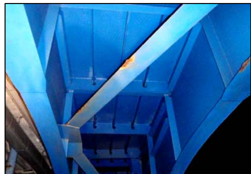
写真-11 部材エッジ部の腐食
