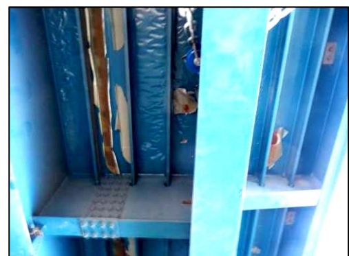
写真-7 鋼床版下面の劣化状況
