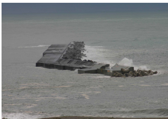
写真-4 防波堤(南)被災後全景(2011年7月20日撮影)
