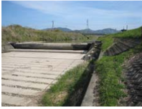
写真-1 瀬切れの様子
