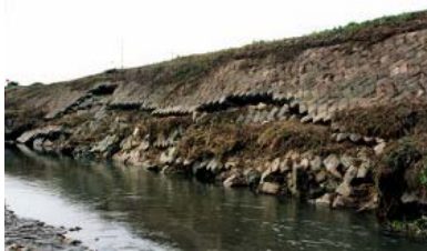
図-1 護岸被災状況
