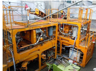
写真-2 流動化砂製造プラント
