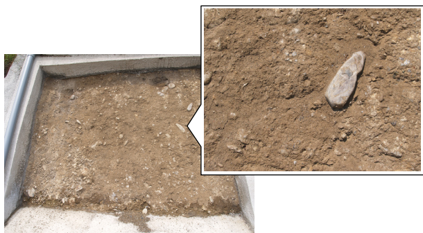
↑法面下端からの若干の浸み出し
